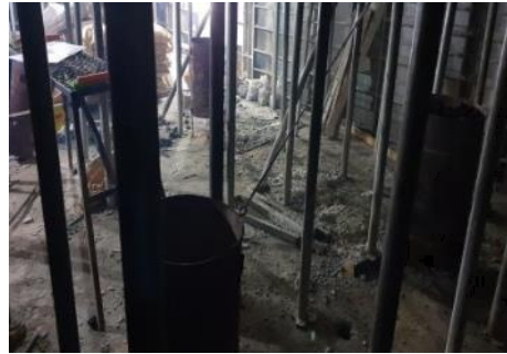
〈옥탑 2층 기계실 내부 모습〉
